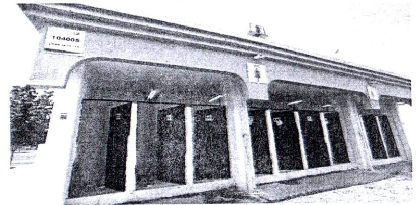
شكل رقم (١): عدم فصل دورات مياه النساء عن الرجال
